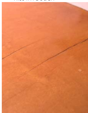
Riss im Boden
